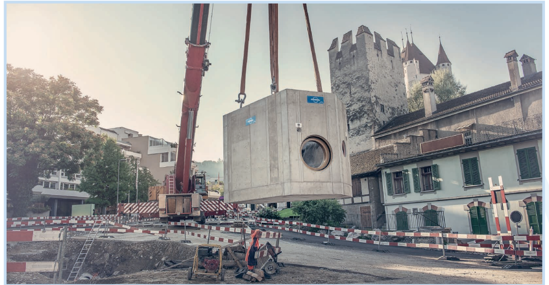
Mischwasserschacht Berntorplatz Thun
