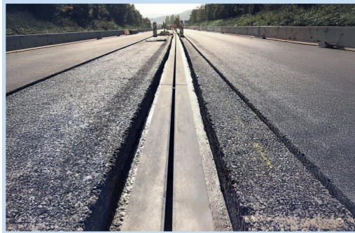
Schwerlastrinne F900 ohne Steg/Querrippe auf der Autobahn Yverdon
