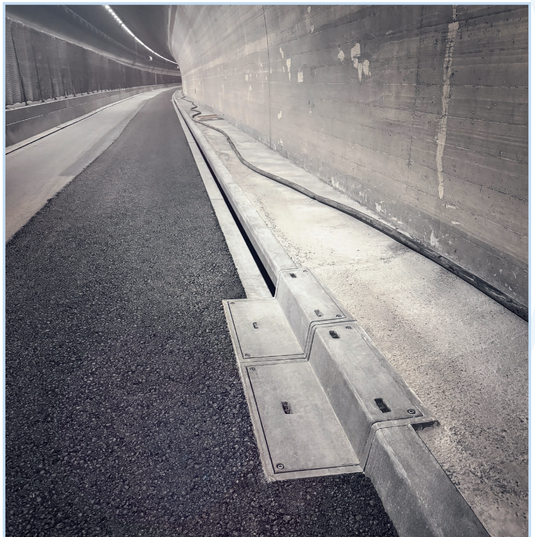
Schlitzrinnen, Randsteine und Siphonschächte Tunnel Bad Zurzach
