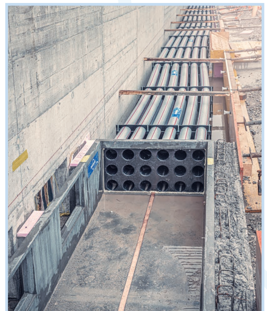
Kabelschacht Einhausung Schwamendingen
