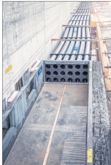
Ein UHFB-Kabelschacht bei der Einhausung in Schwamendingen. [Bild zVg]
