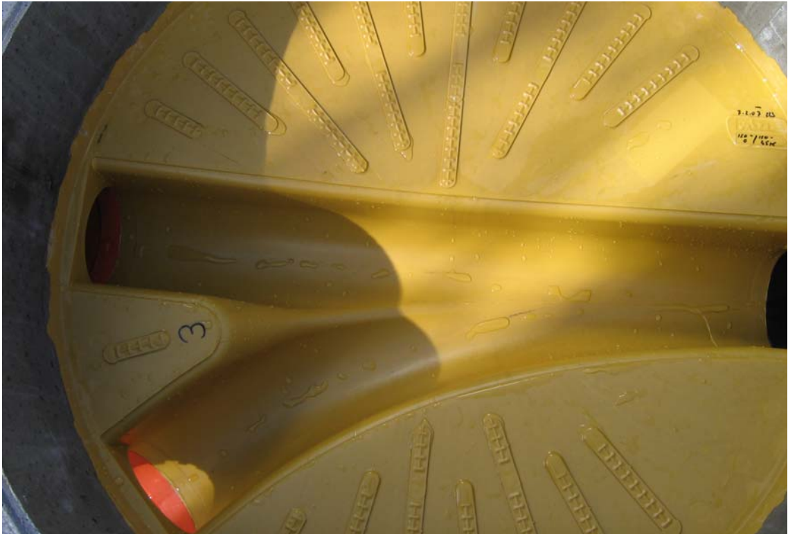
Abbildung 35: Schacht aus PP nach 50 Rohrlängen
