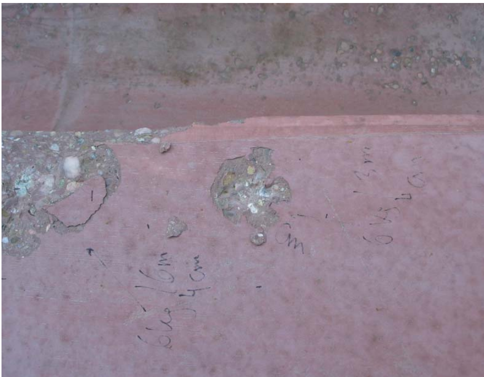
Abbildung 26: Betonschacht – 6kg kg aus 3,0 m in 4 cm Entfernung
