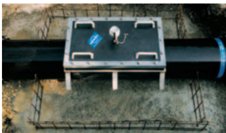
Kontrollöffnung im Schacht für Druckleitung, nach Montage des Verschlussdeckels.
