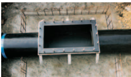
Kontrollöffnung im Schacht für Druckleitung, vor Montage des Verschlussdeckels.
